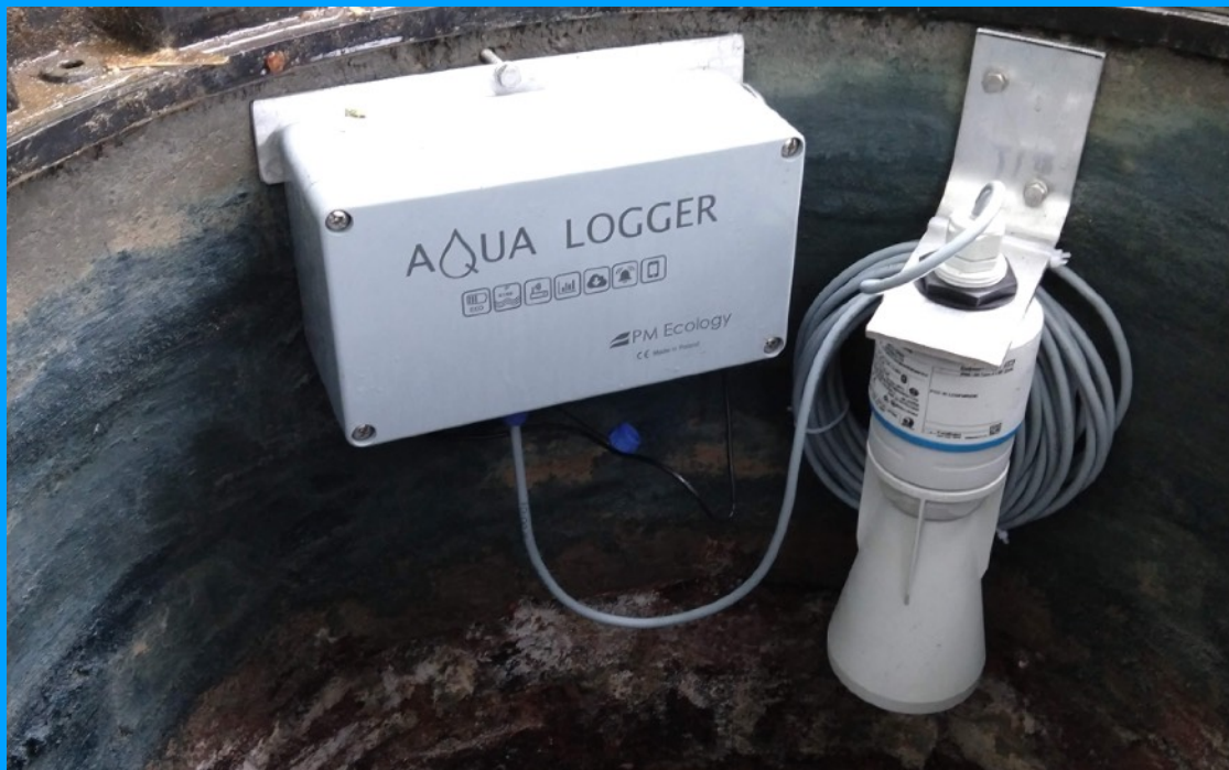
Rysunek 2. Bezkontaktowy pomiar poziomu ścieków w kanalizacji sanitarnej
