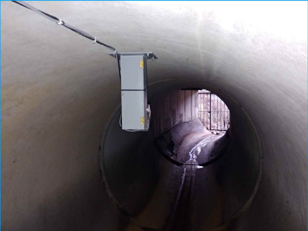
Zdjęcie 2. Sondy urządzenia pomiarowego PM Ecology mierzące ilość zrzutów i ich objętość na kanale wylotowym z przelewu burzowego.
