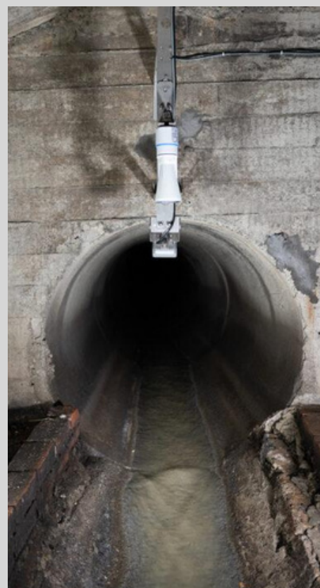
Zdjęcie 1. Urządzenie monitorujące pracę przelewu burzowego PM Ecology. W tym przypadku poza ilością zrzutów monitorowana jest też wielkość napływu do komory, w której umieszczony jest przelew.
